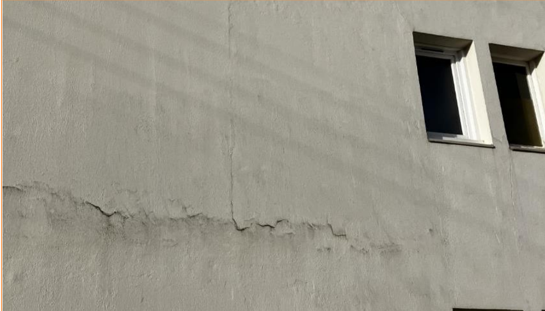
Mauvaise isolation des murs
